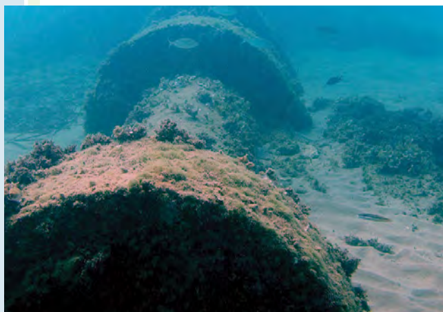
Décharges d'eaux usées par un émissaire sous-marin. Photo : V. Tasso, OCEANSNELL
