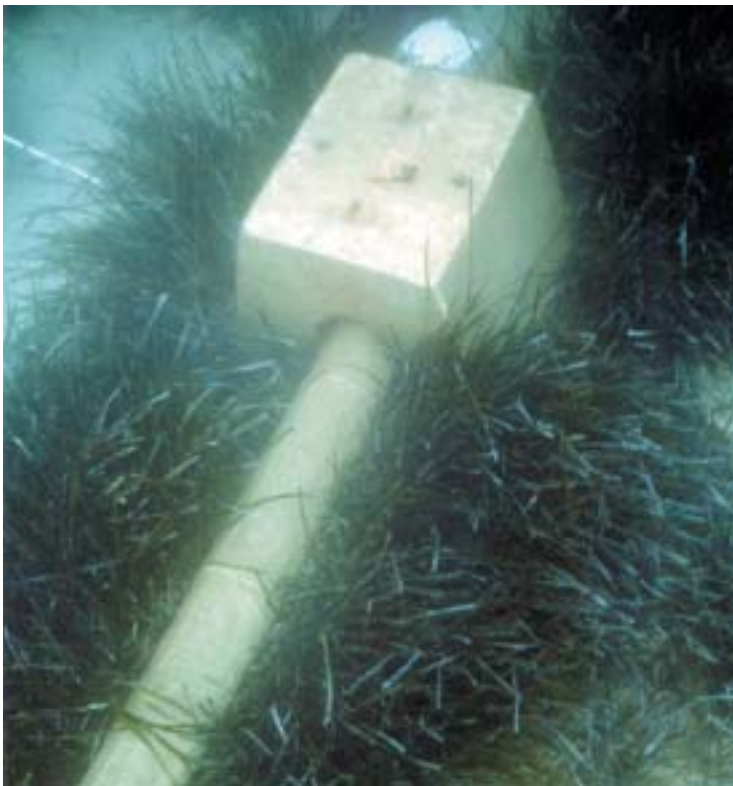
Fig. 119. Fixation d'une canalisation d'eau potable traversant l'herbier à Posidonia oceanica au moyen de "corps-morts". Canalisation sous-marine située entre les îles de Ratonneau et d'If (rade de Marseille, Bouches-du-Rhône, France). D'après Charbonnel et al. (1998). Photo E. Charbonnel.
